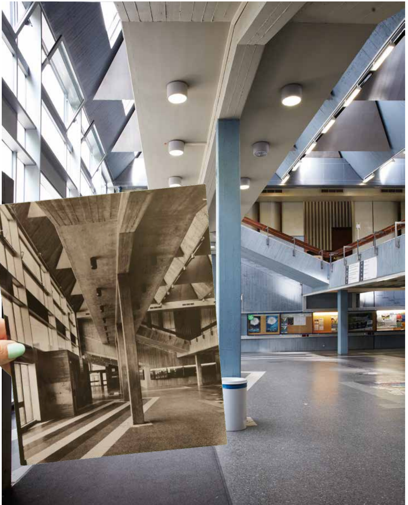
Kaum verändert hat sich das Hörsaalgebäude von innen, wie der Vergleich von altem und neuem Foto zeigt.
